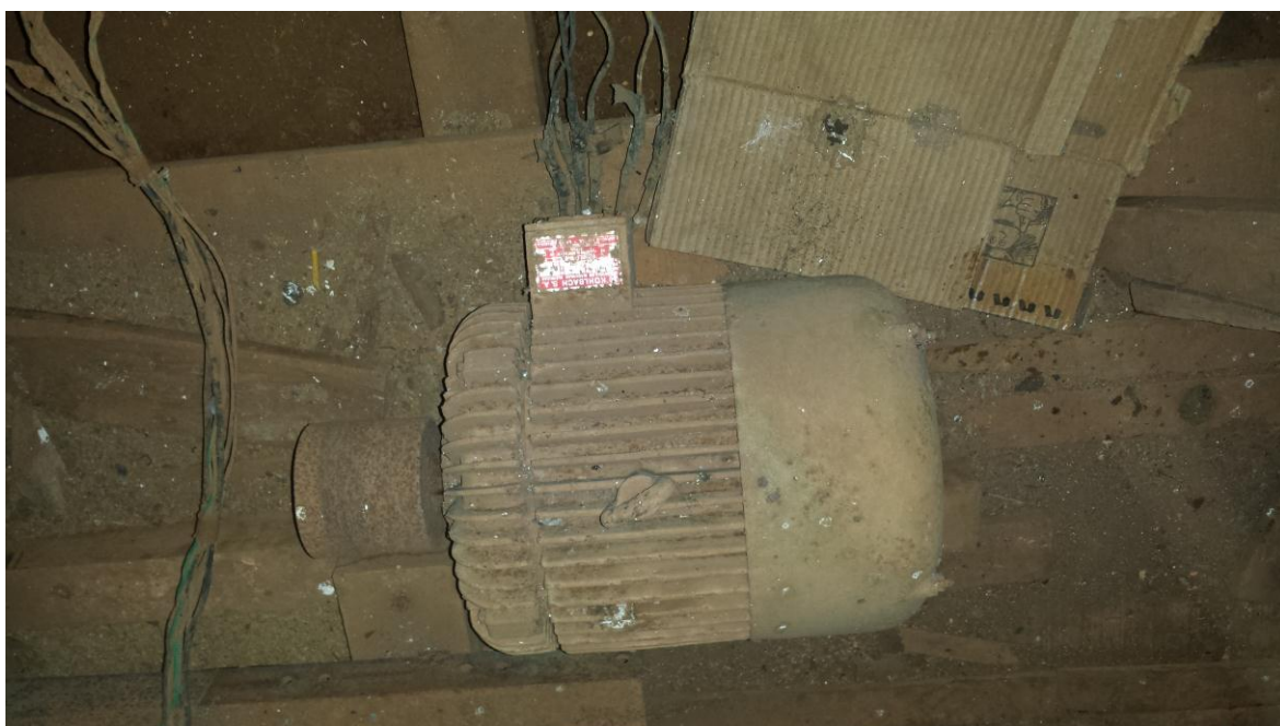
Foto 4 – Vista parcial do motor elétrico, trifásico
