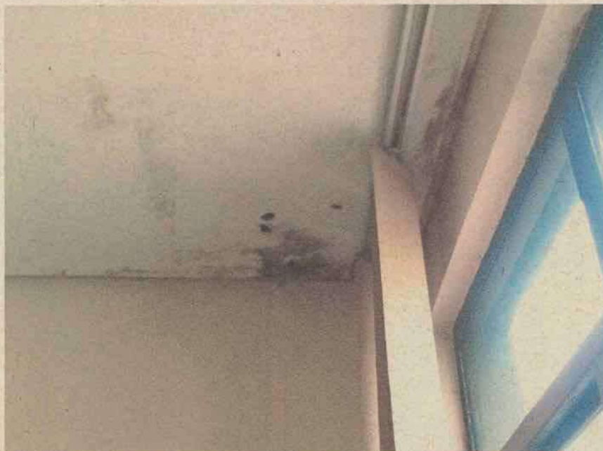
09- VISTA DA INFILTRAÇÃO TETO DA COZINHA
