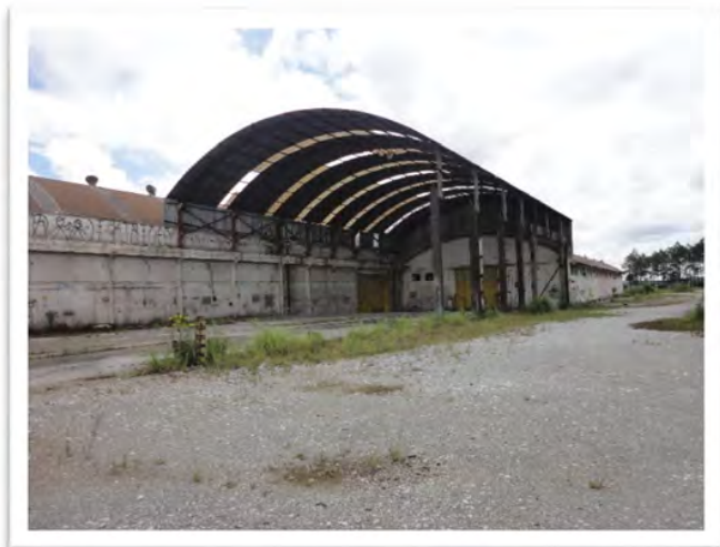
Vista do interior do terreno – vista do que restou dos barracões.
