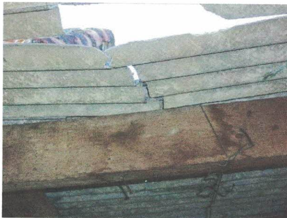
Detalhe da cobertura da garagem – telhas quebradas e madeiramento “selado”
