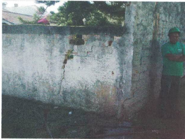
Detalhe do muro frontal - rachadura
