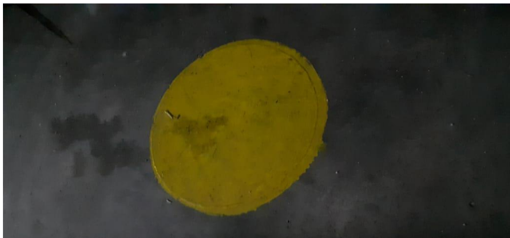
Ausência de numeração da vaga 20 – localizada no subsolo I
