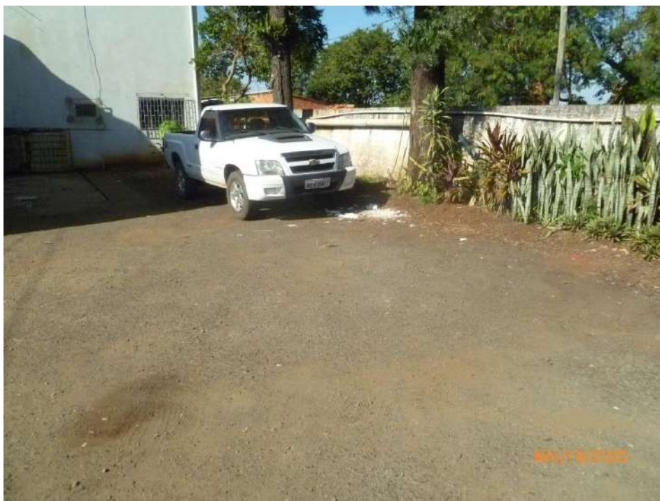
Figura 25 – Vista parcial de parte da área de piso da parte dos fundos do prédio principal, lado direito, com o pavimento em mau estado, apenas com aplicação de pedrisco.
