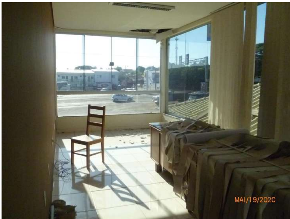
Figura 62 – Pavimento superior - Vista parcial da Sala 3, com destaque para forro de gesso liso parcialmente danificado pela ocorrência de vazamento pelo telhado, inclusive com danos nas persianas. Piso em cerâmica e paredes rebocadas e com pintura látex.
