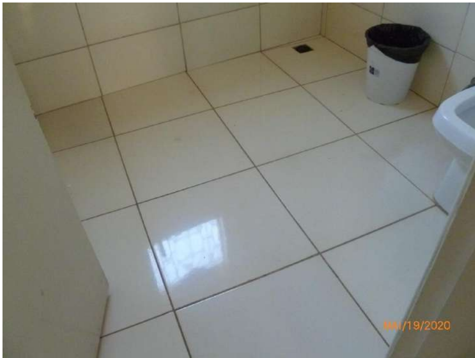
Figura 58 – Pavimento superior - Vista parcial do Banheiro, com destaque para piso revestido com cerâmica.
