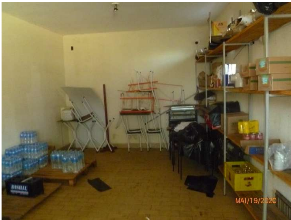
Figura 40 – Pavimento térreo - Vista parcial do depósito 1, com paredes rebocadas e pintura látex e piso em cerâmica. Teto rebocado e pintura látex.
