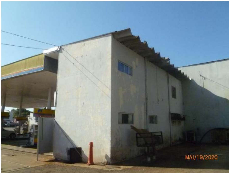
Figura 24 – Vista parcial da fachada lateral direita e parte da fachada de fundos do prédio de 2 pavimentos com parede revestida com reboco feltrado e pintura em látex em mau estado. Parte das janelas em vidro temperado e perfis de apoio em alumínio e parte com janelas de correr – esquadria metálica. Destaque para a cobertura com telhas de cimento amianto tipo “canalete” apoiadas sobre as paredes.
