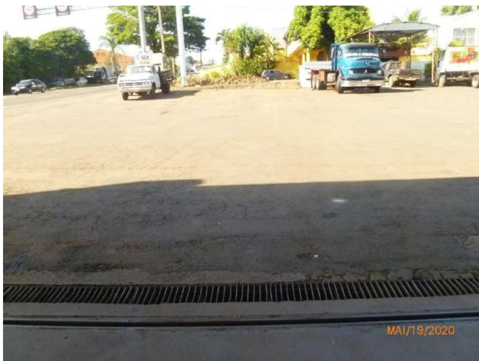
Figura 17 – Vista parcial da área de piso do estacionamento/área de manobras, com destaque para o mau estado do capeamento asfáltico.
