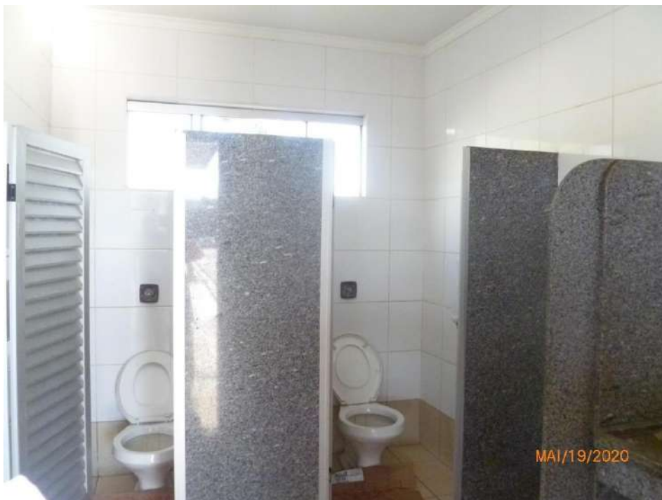
Figura 28 – Pavimento térreo - Vista interna do sanitário de apoio à área de abastecimento, com destaque para divisórias em granito, portas em alumínio, paredes com azulejos, pisos cerâmicos, louças sanitárias brancas.
