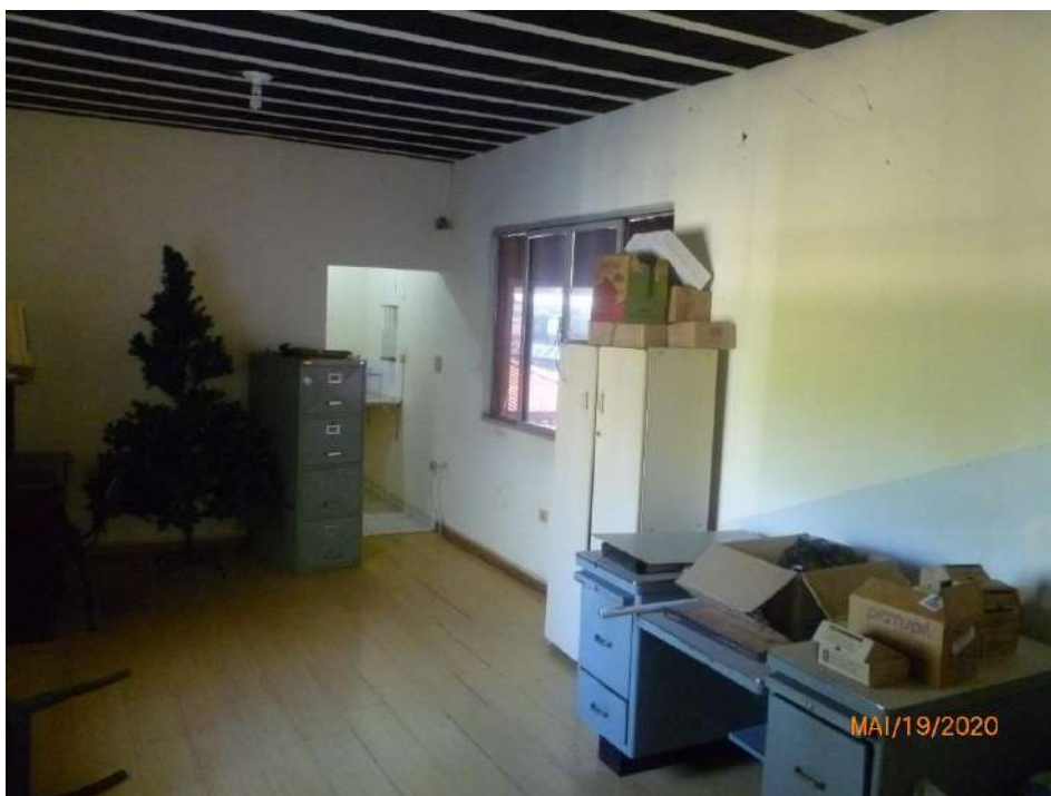
Figura 49 – Pavimento superior - Vista parcial da Sala 4, com laje pré-moldada aparente e com pintura látex. Piso em laminado de madeira em mau estado. Paredes rebocadas e pintura látex.
