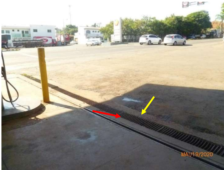
Figura 14 – Vista parcial da área de piso do setor de abastecimentos com a visualização de canaletas metálicas, grelhas instaladas na lateral do lado de maior dimensão, encontro com necessidade de reparos, inclusive de calçada (considerada na área descoberta) com trecho comprometido. Visualiza-se também a extinção da capa asfáltica aplicada sobre o piso em paralelepípedos.
