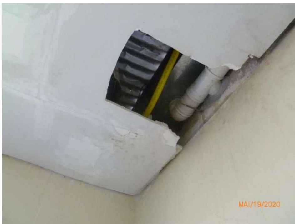
Figura 61 – Pavimento superior - Vista parcial da Sala 2, com destaque para forro de gesso liso parcialmente danificado pela ocorrência de vazamento pelo telhado, permitindo a visualização parcial da estrutura metálica da cobertura, trecho de calhas com chapa galvanizada e telhas metálicas.
