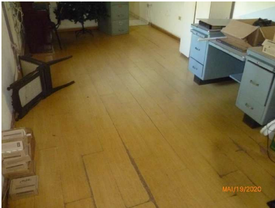
Figura 50 – Pavimento superior - Vista parcial da Sala 4, com destaque para o piso revestido com laminado de madeira em mau estado.
