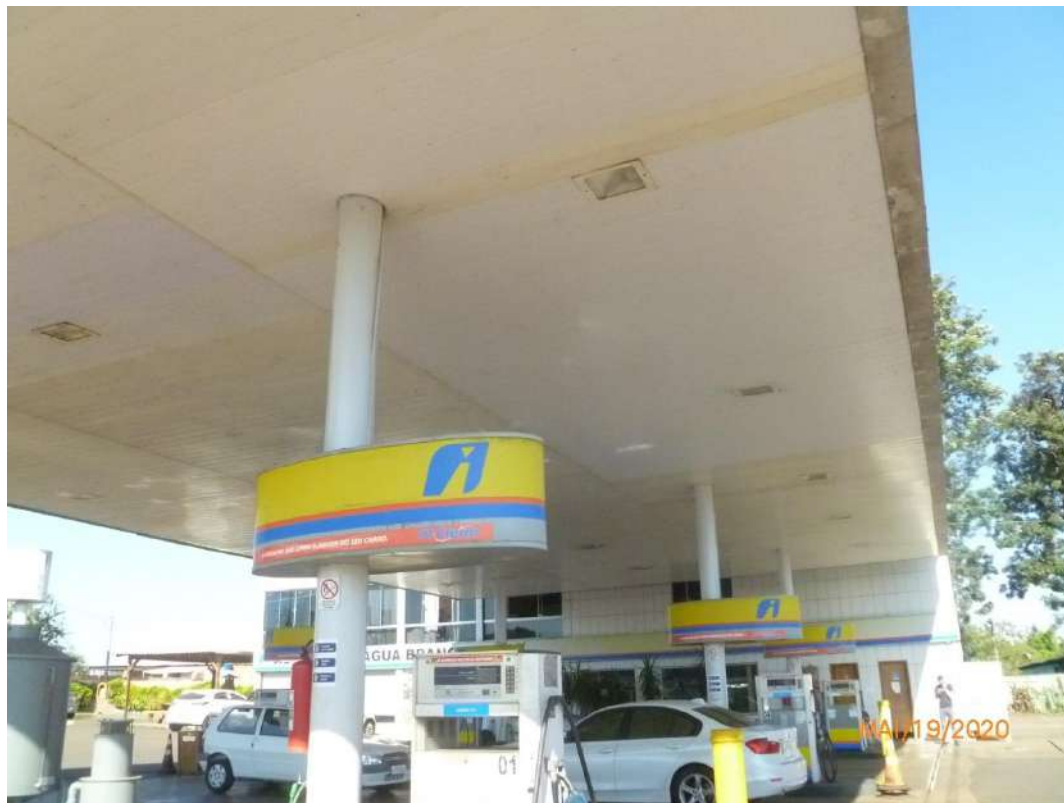
Figura 11 – Vista parcial da área de abastecimento sob cobertura com estrutura metálica e forro de PVC. Área de forro necessitando de recuperação e limpeza.
