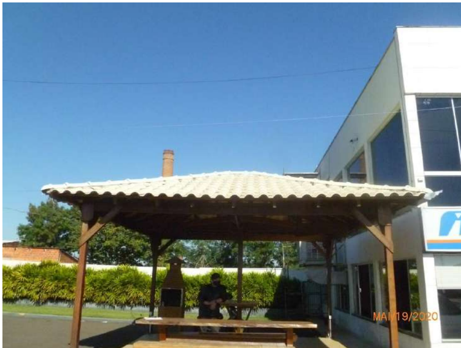
Figura 26 – Vista parcial de parte da área anexa – “churrasqueira” – coberta com telhas de barro e estrutura em madeira para a cobertura e pilares, apresentando situações de deformações em peças de madeira, com necessidade de reparos.
