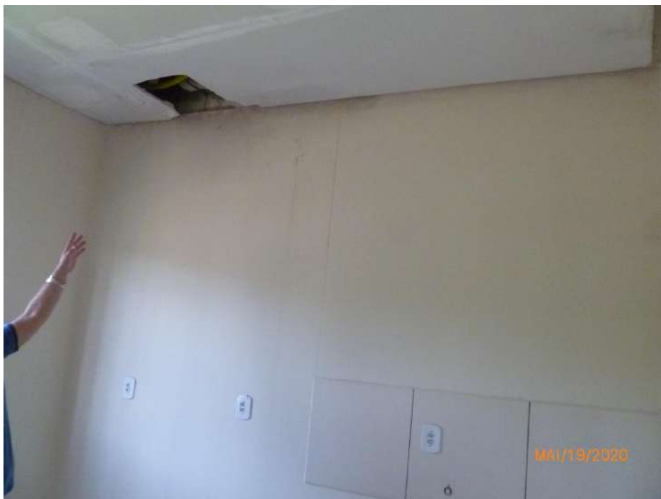
Figura 60 – Pavimento superior - Vista parcial da Sala 2, com destaque para forro de gesso liso parcialmente danificado pela ocorrência de vazamento pelo telhado.
