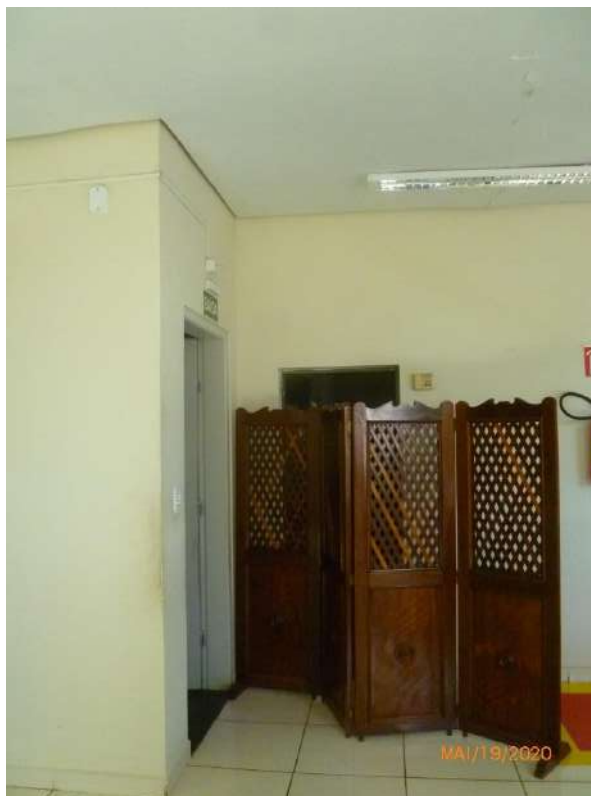
Figura 44 – Pavimento superior - Vista parcial da entrada para o pavimento superior a partir da escadaria, com porta de giro abrindo sobre os degraus da escadaria. Piso revestido com cerâmica e teto com forro de gesso liso apoiado em estrutura metálica da cobertura.
