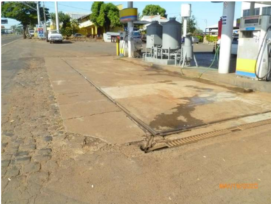
Figura 15 – Vista parcial da área de piso sob a cobertura das ilhas, visualização de canaletas metálicas, grelhas instaladas na lateral do lado de maior dimensão, encontro com necessidade de reparos, inclusive de calçada (considerada na área descoberta) com trecho comprometido. Visualiza-se também a extinção da capa asfáltica aplicada sobre o piso em paralelepípedos.
