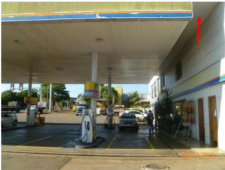
Figura 20 – Vista a platibanda de fechamento da estrutura metálica de cobertura com a pintura deteriorada. Destaque para a área de cobertura leve (indicação pela seta em vermelho) no trecho entre o prédio de dois pavimentos e a cobertura das ilhas.
