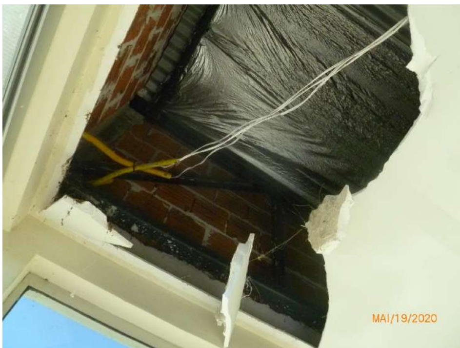
Figura 63 – Pavimento superior - Vista parcial da Sala 3, com destaque para forro de gesso liso parcialmente danificado pela ocorrência de vazamento pelo telhado. Visualização de instalação de manta para isolamento térmico.
