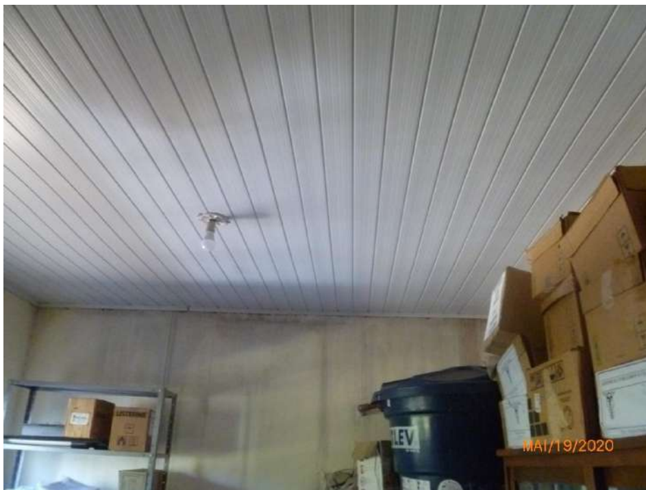
Figura 46 – Pavimento superior - Vista parcial do Depósito anexo à Sala 4 (indicação figura 10). Teto com forro em PVC fixado na estrutura de apoio para as telhas de cimento amianto, tipo “canalete”. Paredes com sinais de infiltrações. Destaque para caixa d’água potável para o atendimento dos sanitários de apoio ao setor de abastecimento do pavimento inferior.
