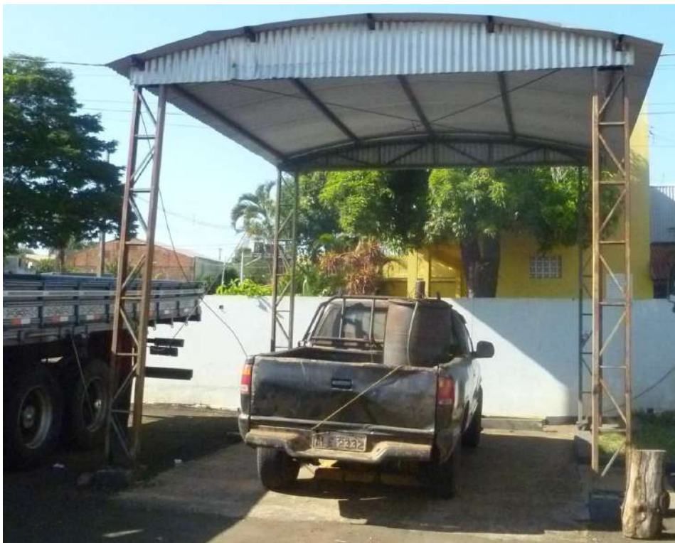
Figura 27 – Visualização da área do “trocador e óleo”, com pilares metálicos, estrutura de cobertura metálica, telhas metálicas, necessitando de repintura da parte da estrutura.
