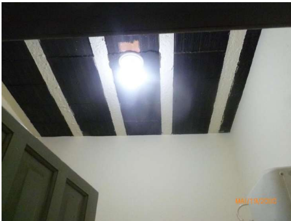
Figura 48 – Pavimento superior - Vista parcial do teto WC entre o Depósito e a Sala 4, com laje pré-moldada aparente e com pintura látex.
