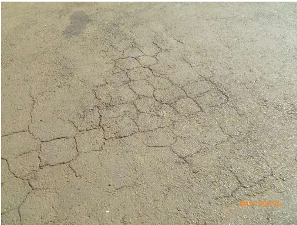
Figura 18 – Vista parcial da área de piso do estacionamento/área de manobras, com destaque para o mau estado do capeamento asfáltico, destacando a base em paralelepípedos.
