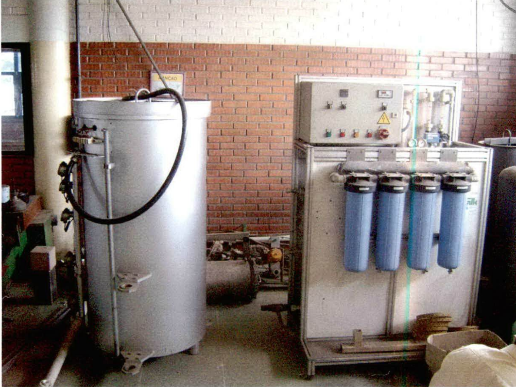
03- Vista partes do Forno elétrico
