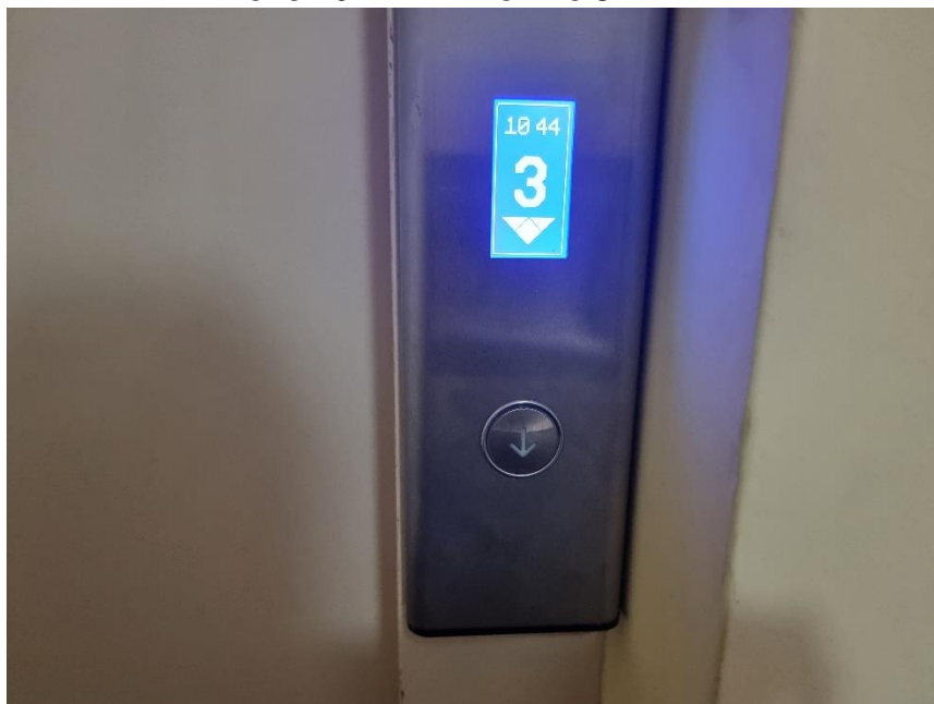
FOTO 10 – ELEVADOR NO 3º ANDAR
