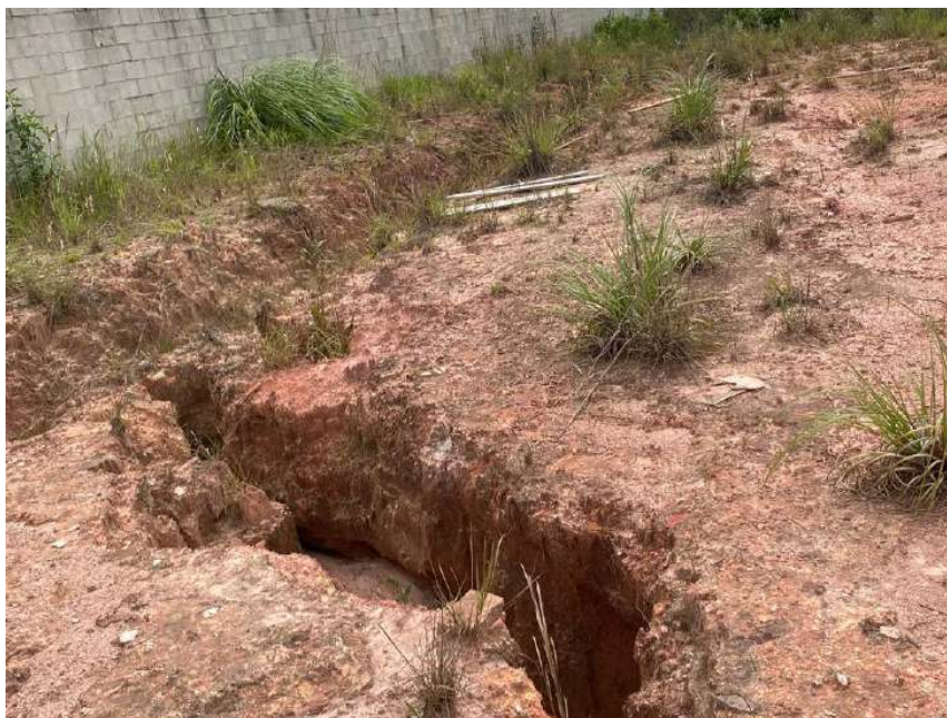
Foto 12 – Sinais de erosão do solo no imóvel.
