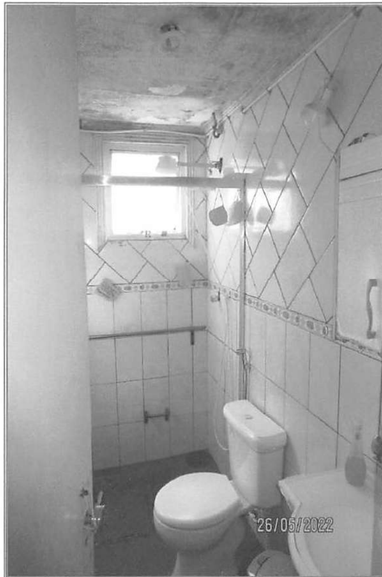
Foto nº 19: Vista geral do banheiro, com detalhe para o teto com vestígios de infiltração.
