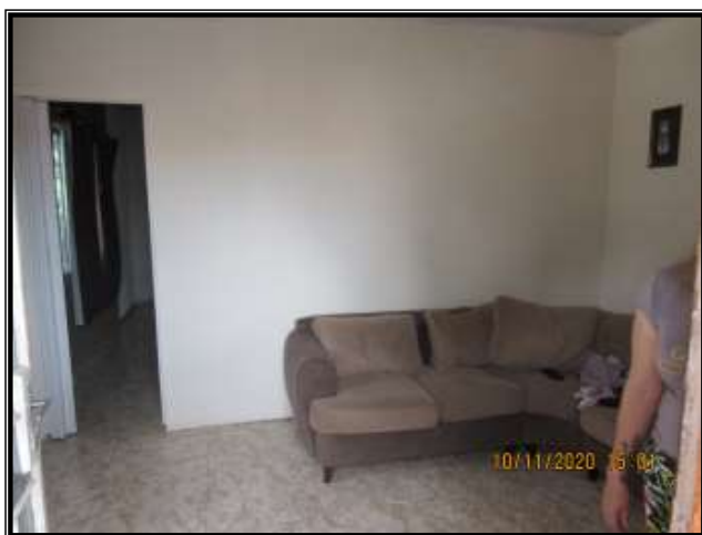
Foto nº 13 Vista parcial da sala pavimento superior Possuindo piso cerâmico; paredes em alvenaria convencional; com teto em forro de PVC; porta de madeira e janela de alumínio com vidro.
