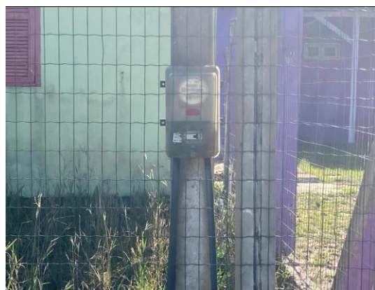
MEDIDOR DE ENERGIA
