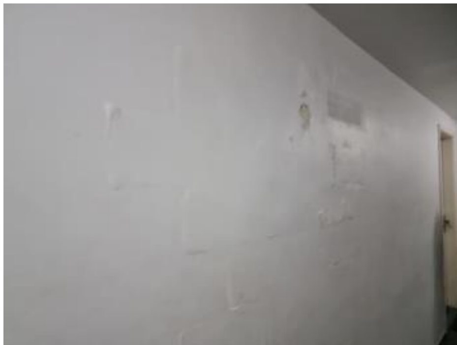
FOTO 20 – FOTO DA PAREDE DO I.A. NO CORREDOR DO LADO DE FORA EM FRENTE A ESCADA (POSSÍVEL INFILTRAÇÃO)
