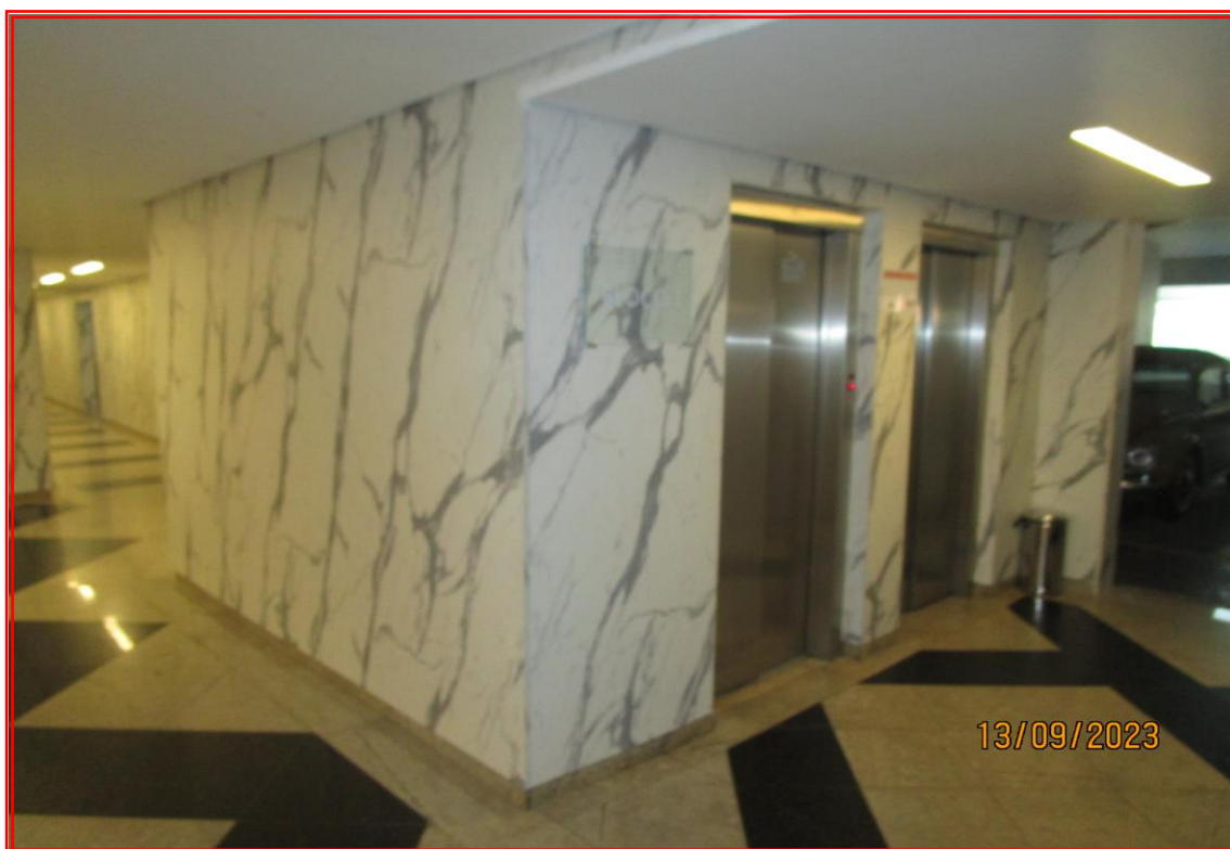
Foto nº 16: Vista parcial do hall de elevador de uso exclusivo do Bloco I.
