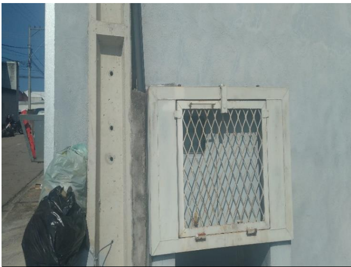
MEDIDOR DE ENERGIA ELÉTRICA
