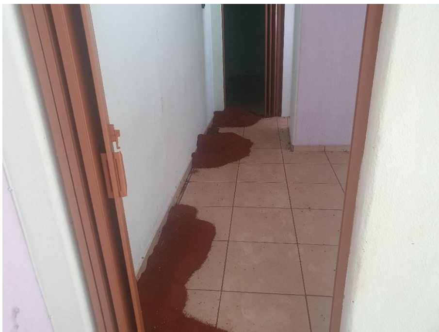
Foto 05/437 fundos – Sala , piso cerâmico, paredes rebocadas, forro em pvc, presença de formigueiros no interior da casa, paredes com trincas de recalque.
