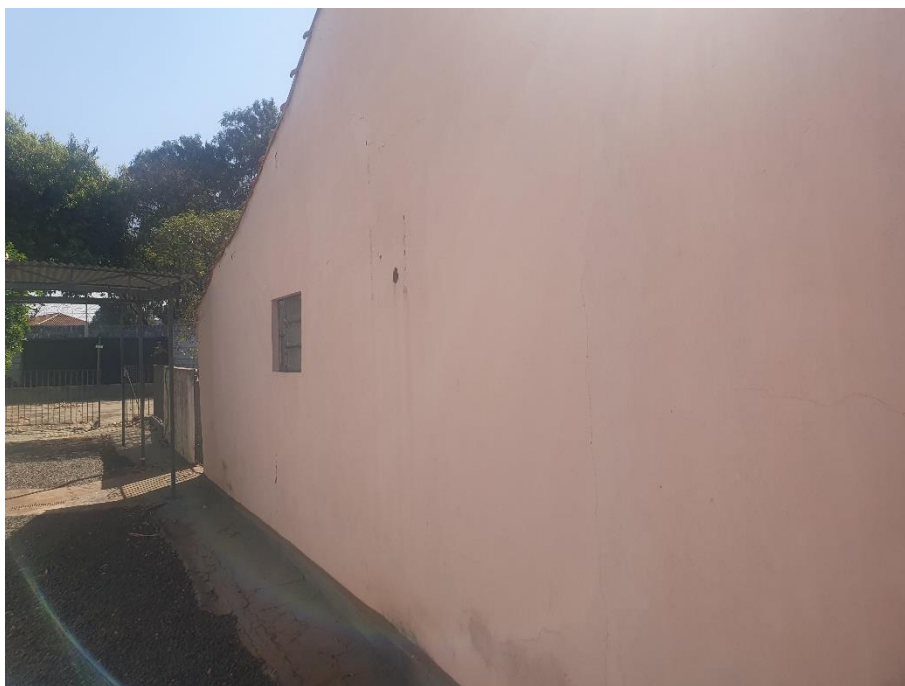
Foto 02/429 – Corredor Lateral contendo uma parte do piso em pedrisco e outra parte pavimentado e concreto com algumas rachaduras de dilatação, na lateral consta também uma garagem com estrutura metálica e telha galvanizada, ao lado da garagem existe um muro de baixa altura complementado com gradil metálico.
