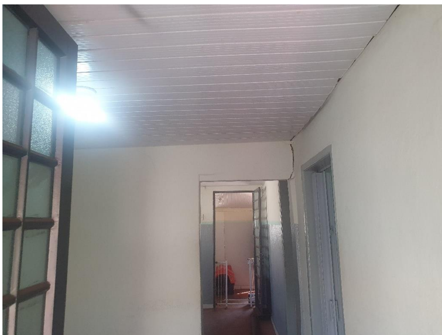
Foto 03/429 – Sala – Piso cimentado vermelhão, paredes com reboco, forro em PVC, com trinca de recalque acima do batente da porta
