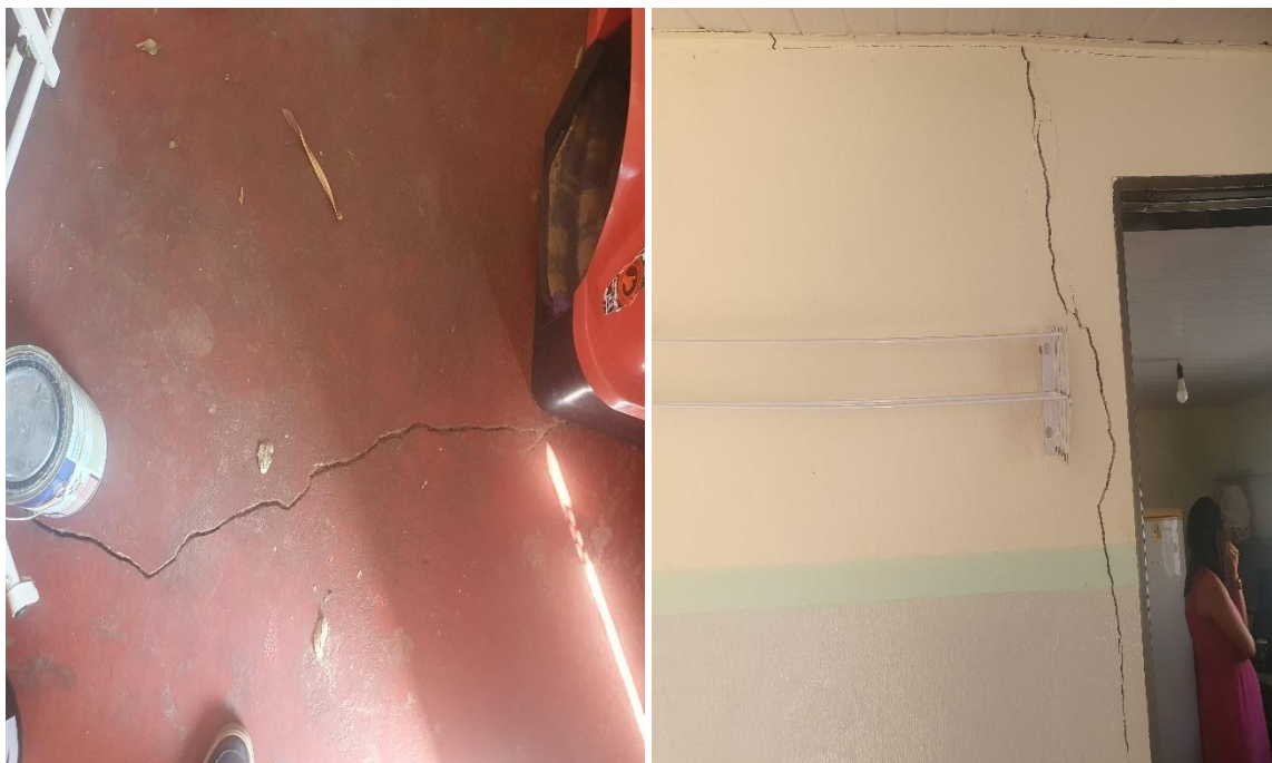
Foto 08 e 09/429 – Área de serviço – Piso com trinca de recalque que se estende pela parede de fundos.
