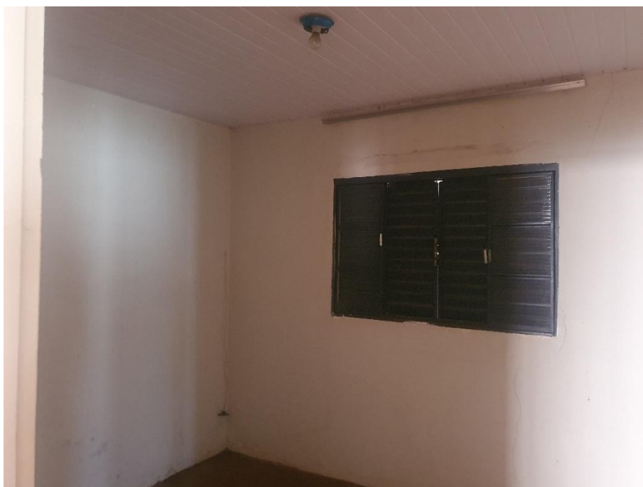
Foto 04/437 – Quarto 2 - contendo piso cerâmico vermelho, paredes rebocadas e forro em pvc, presença de algumas trincas de dilatação.
