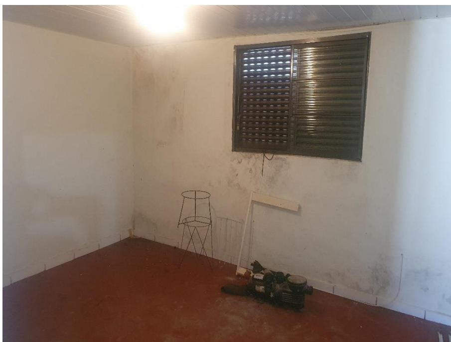
Foto 06/429 – Quarto 2 – Piso cimentado vermelhão, paredes com reboco, forro em PVC, com mancha de umidade de percolação na parede lateral.
