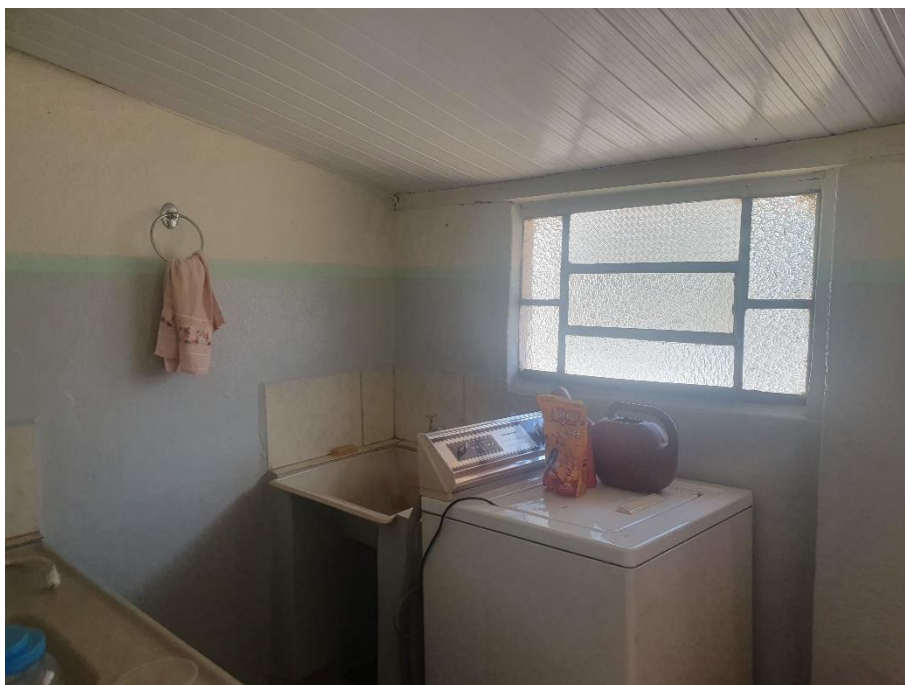
Foto 07/429 – Área de serviço – Piso cimentado vermelhão, paredes com reboco, forro em PVC, com mancha de umidade de percolação na parede lateral.
