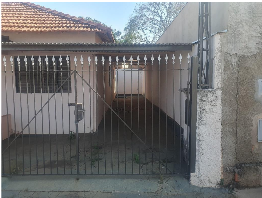
Foto 02/437 – Corredor Lateral contendo piso pavimentado em concreto com algumas rachaduras de dilatação. Na lateral consta também uma garagem com estrutura em telha de fibrocimento, contendo algumas telhas faltantes e outras quebradas.
