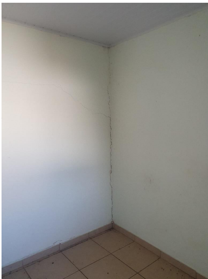
Foto 07/437 fundos – Quarto, piso cerâmico, paredes com reboco, forro em pvc, presença de trinca de recalque
