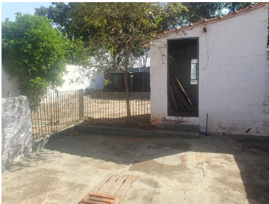
Foto 10/429 – Fundos e Depósito – Piso cimentado com algumas trincas de dilatação, paredes com reboco, se- forro em mau estado de conservação.
