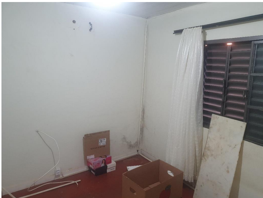
Foto 04/429 – Quarto 1 – Piso cimentado vermelho, paredes com reboco, forro em PVC, com mancha de umidade de percolação na parede lateral.
