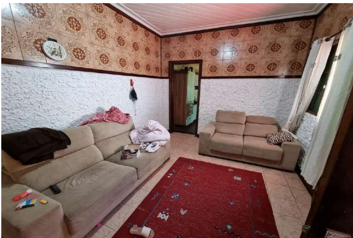
FOTO 76 - Vista da sala de estar. Apresentando padrões construtivos de piso cerâmico, alvenarias revestidas com cerâmica ao topo em meia parede com pintura látex PVA sobre chapisco, forro de madeira e esquadrias em madeira.
