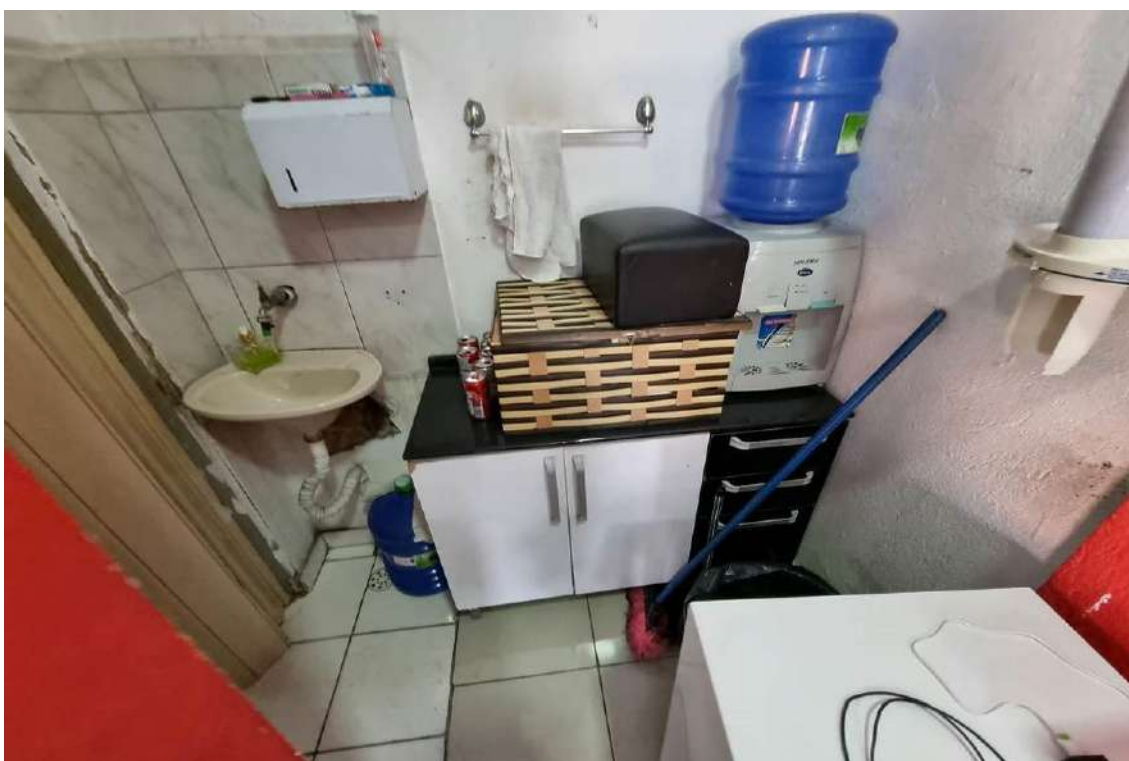
FOTO 44 - Vista do acesso ao banheiro da loja. Apresentando padrões construtivos de piso cerâmico, alvenarias com revestimento cerâmico em meia parede e teto com forro de PVC.
