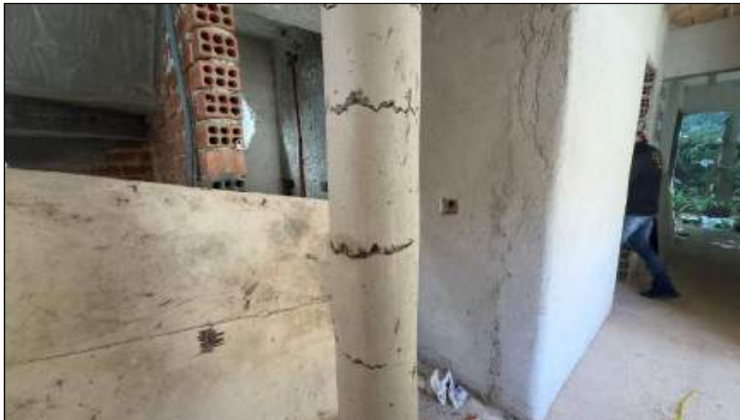
Elemento estrutural com várias trincas
