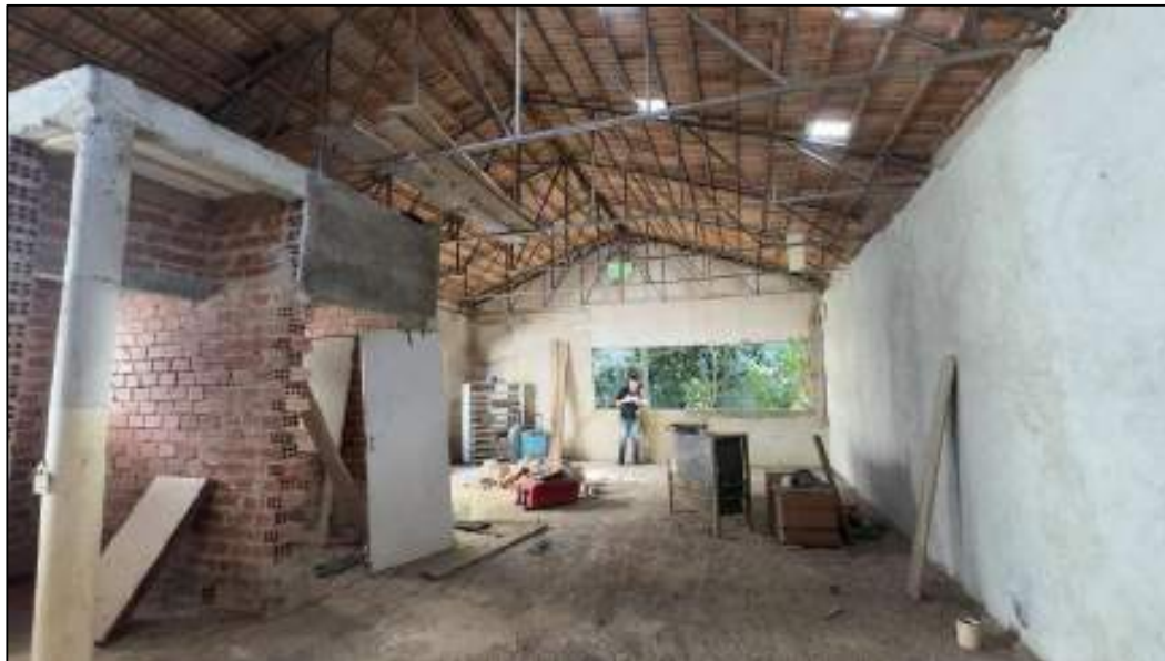
Vista geral da construção inacabada – Pavimento superior – Estruturas construídas de forma incorreta
