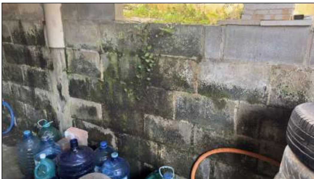
Vista geral de umidade na garagem
