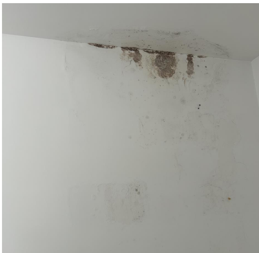
Foto 21 – Vazamento de água
