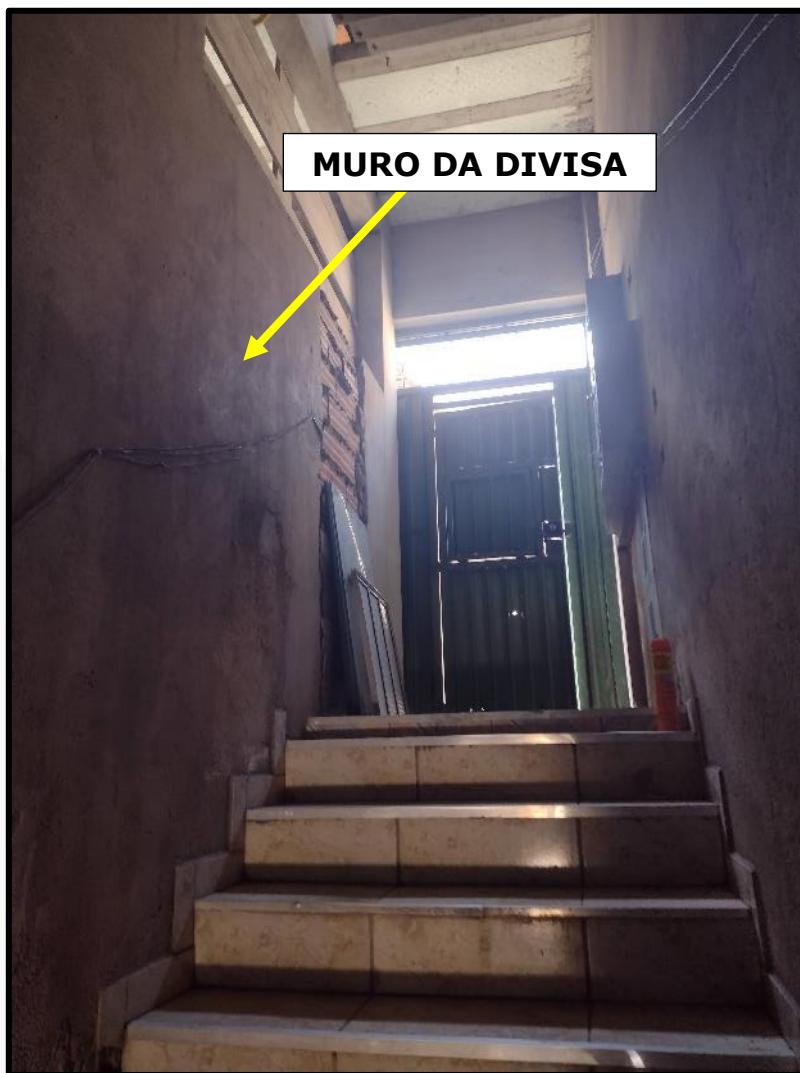
PORTÃO DO CORREDOR DE ACESSO ÀS EDIFICAÇÕES DO SUBSOLO, PODENDO SE OBSERVAR O MURO DA DIVISA COM A GARAGEM, LOCAL QUE DÁ ACESSO AOS DEMAIS PAVIMENTOS.
