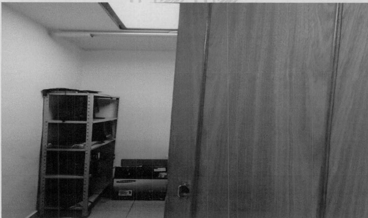
Foto - 67 - Sala de Servidores
