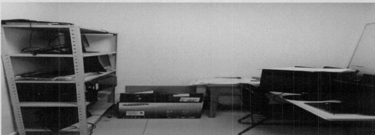
Foto - 65 - Sala Servidores
