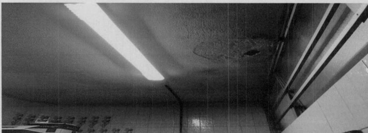
Foto - 51 - Dano Teto Vestiário Funcionários
