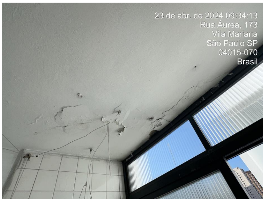
FOTO 11 - Danos na pintura do teto da lavanderia.
