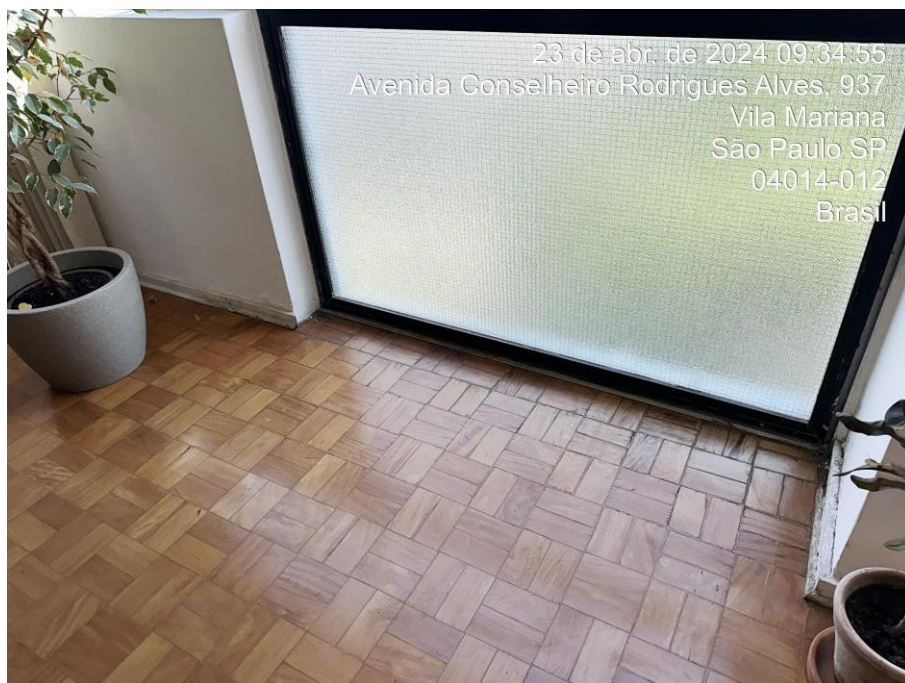
FOTO 15 - Detalhes do piso em taco com sinais de umidade.
