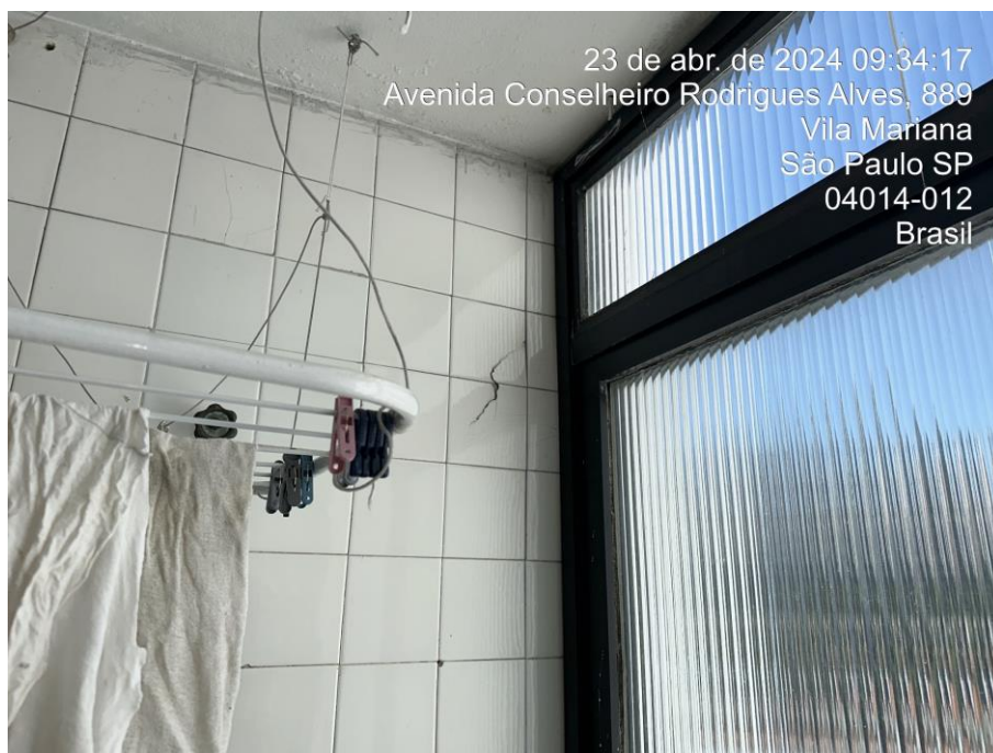
FOTO 12 - Danos nos azulejos da parede da lavanderia.
