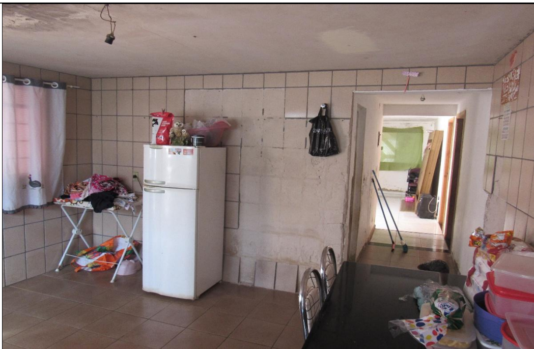
FOTO 11 – Vista geral da sala de jantar do imóvel com azulejos faltantes.
