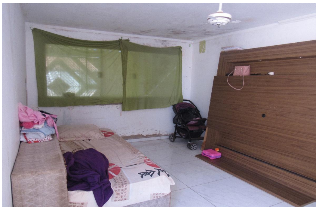
FOTO 06 – Vista geral da sala de estar do imóvel. Nota-se umidade advinda da cobertura.
