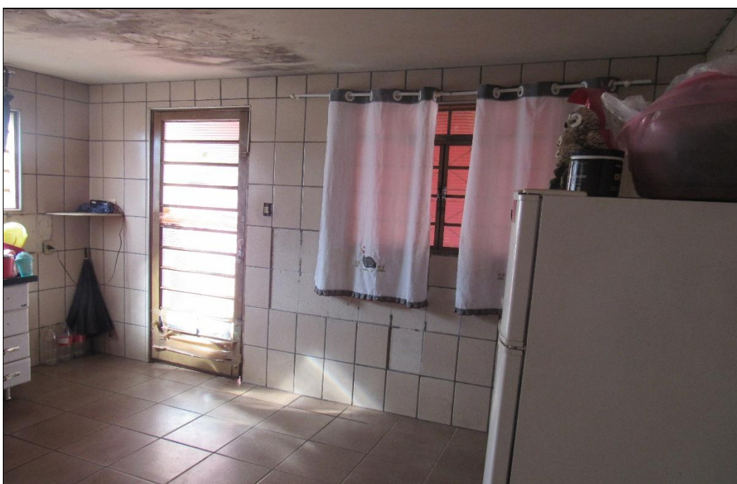
FOTO 10 – Vista geral da cozinha do imóvel. Nota-se umidade advinda da cobertura.
