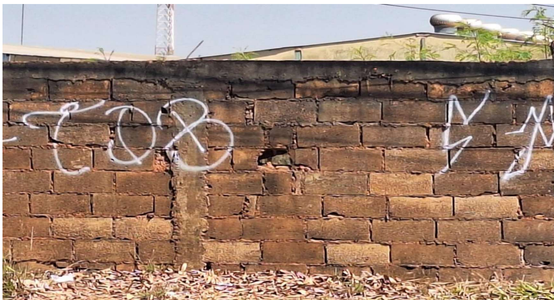
Buraco no muro, de onde foi possível visualizar parte do terreno próximo ao local onde seria o lote 190
