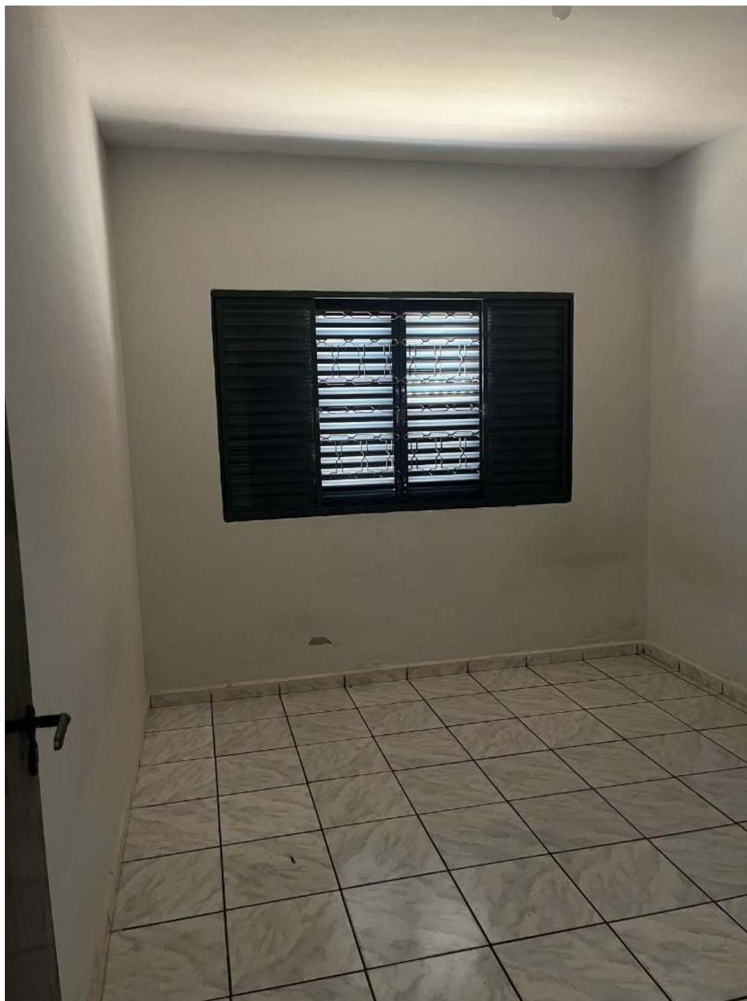
FOTO 06 – Vista parcial do segundo dormitório do imóvel. Nota-se desgaste na pintura.
