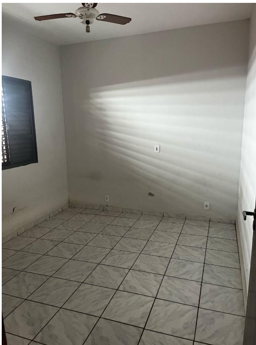
FOTO 05 – Vista parcial do dormitório. Nota-se desgaste na pintura
