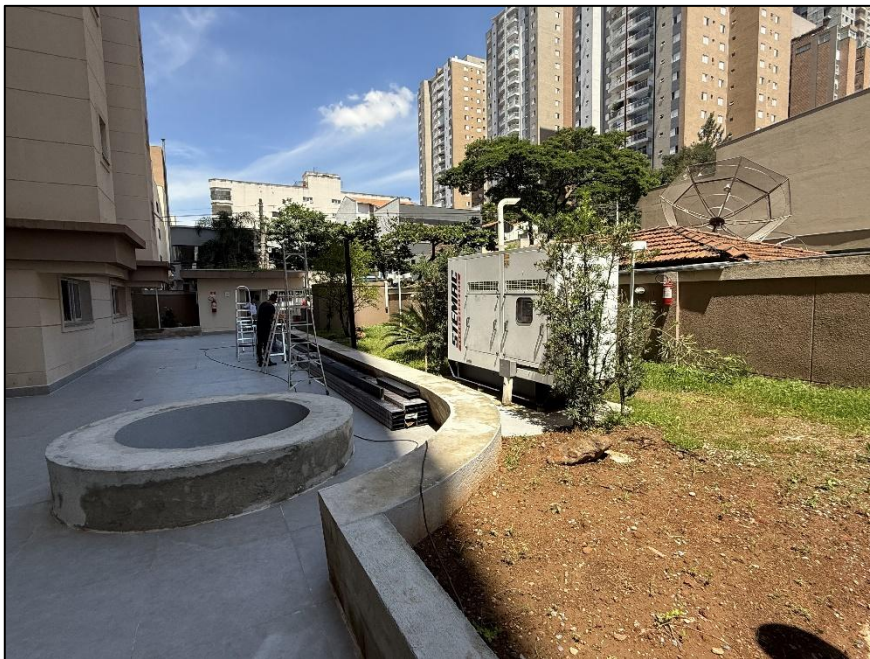
Foto 15 – Vista da circulação interna do condomínio com gerador junto à lateral.
